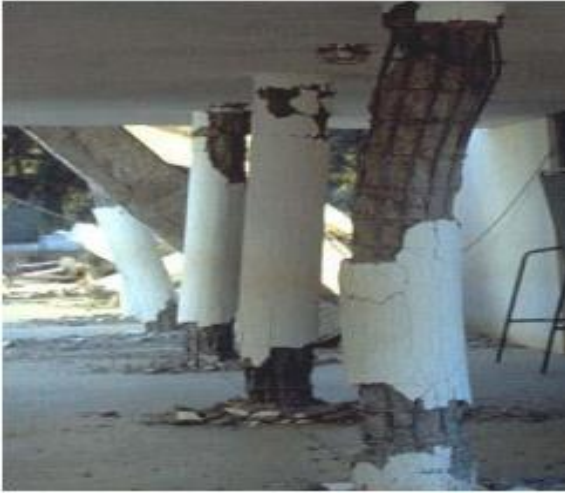
Figure II.10 : flambement des poteaux [14].
