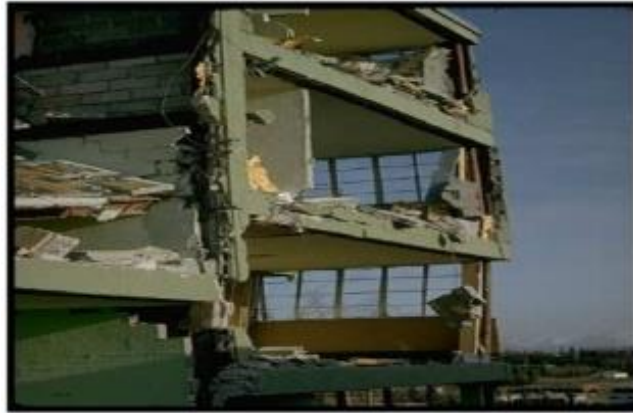
Figure II.15 : Dislocation des remplissages de maçonnerie [14].
