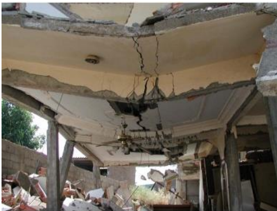
Figure II.12 : Rupture par flexion des poutres [5].
