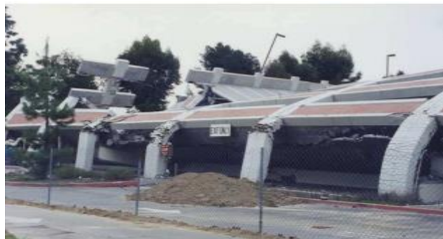
Figure II.14 : Effondrement par flexion hors plan d'une structure portiques béton armé (parking) lors du séisme de Northridge (Etats-Unis) en 1994 [11].
