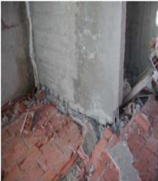
Figure II.16 : Rupture de section à la base des voiles [5].
