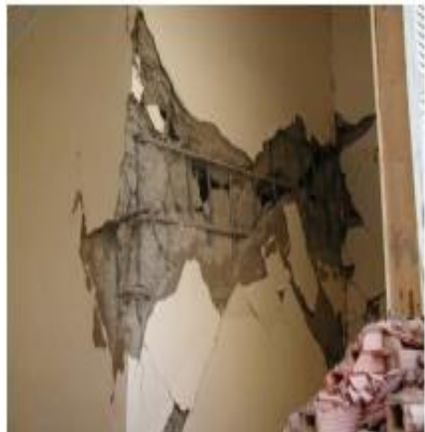
Figure II.17 : Fissures ouvertes dans le voile [5].
