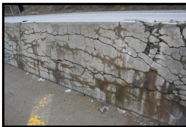
Figure I.5. Détérioration du béton sous l'effet d'alkali réaction.
