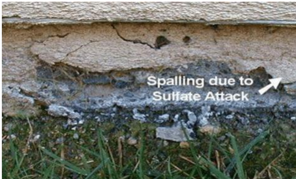
Figure III.5: Dégradations causées par les attaques Sulfatiques.
