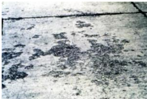
Figure III.2: Détérioration de la surface du béton par Les cycles de gel dégel
