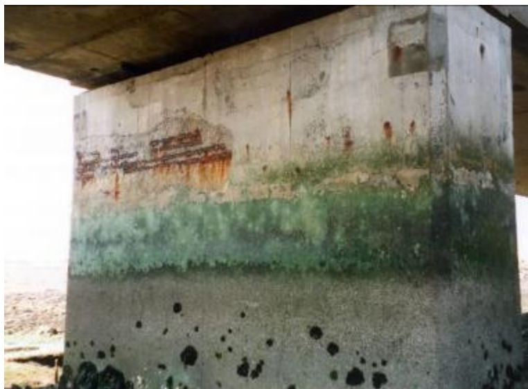
Figure III.3: Dégradations causées par les attaques chimiques
