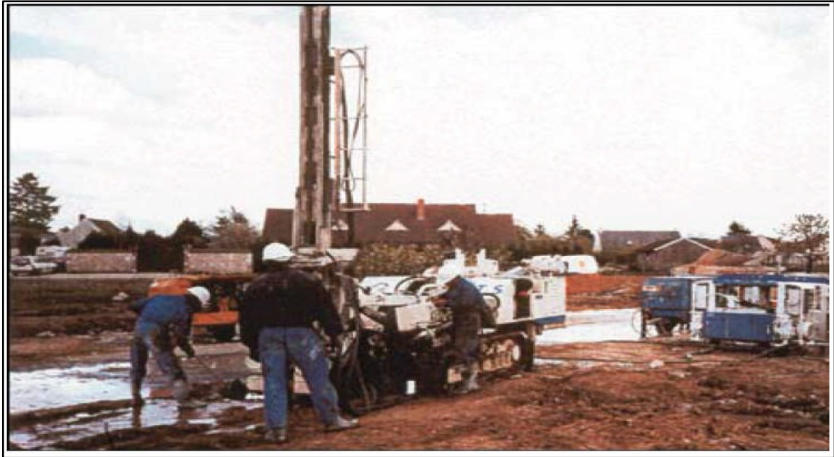
Figure I.13 Image représentant un atelier de forage et pompes d'injection
