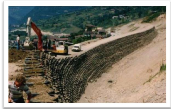
Figure(II.5) :Protection contre le chute de blocs.
