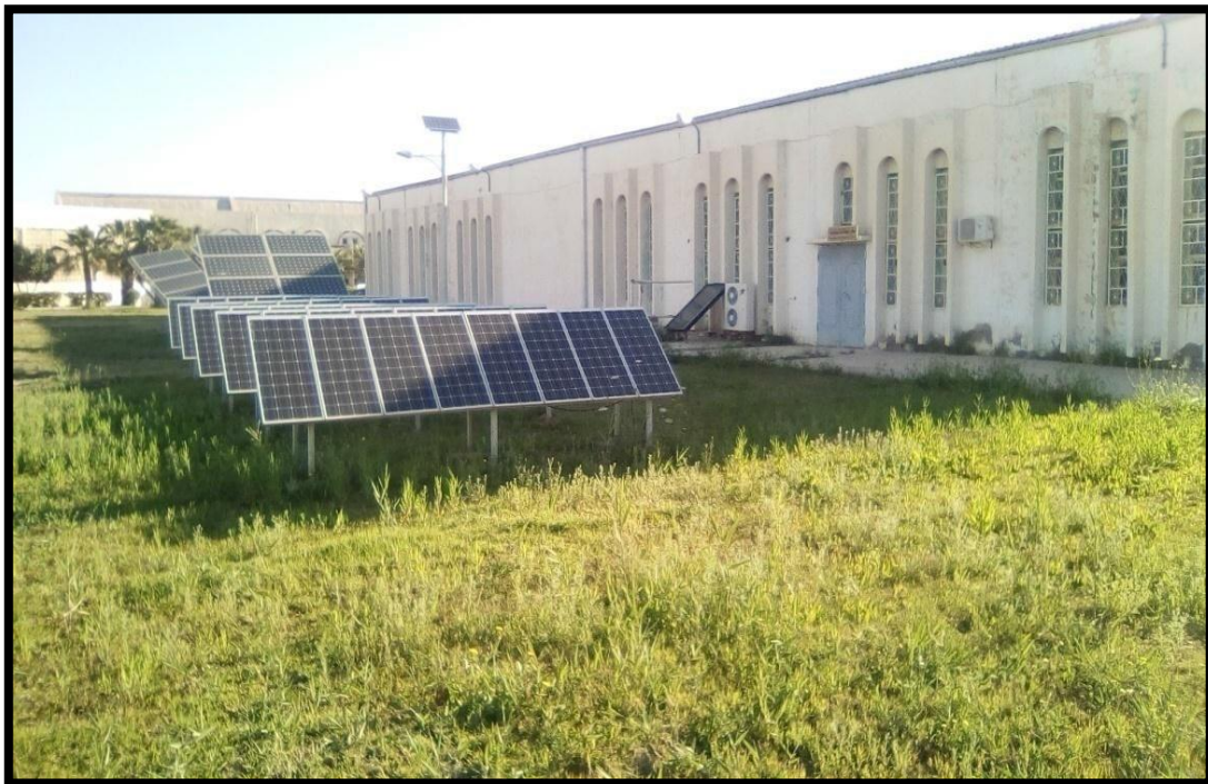
Figure II-2: Vue d'ensemble de la microcentrale photovoltaïque.
