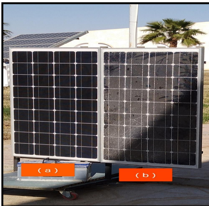
Figure II-5: Les modules PV utilisés dans notre étude (a) Non dégradé (b) dégradé
