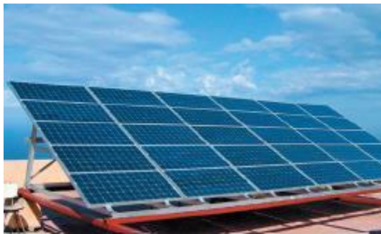
Fig.1.10 Vue d'une installation photovoltaïque (Photo du Centre de Développement des Energies Renouvelables – CDER, Bouzaréah).
