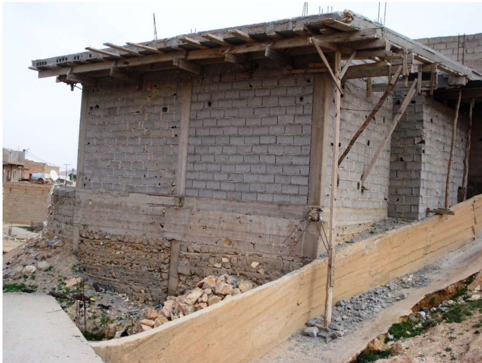
Image 6. Construction anarchique dans la palmeraie de Boussaâda.
