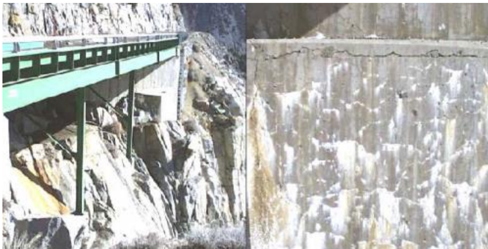
Figure2. 3 : Des cas pathologiques d'éléments en béton en contact de sulfate. [30]
