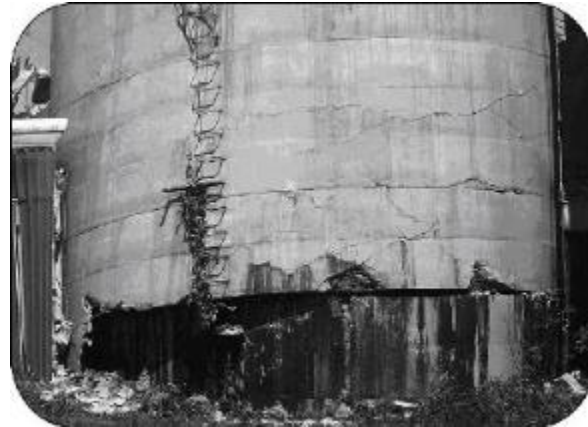
Figure 2.8. : La détérioration des silos-tours en béton due à l'attaque des acides d'ensilage.
