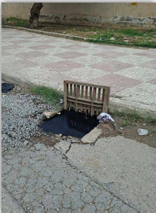
صورة(09) لتعطل البنية التحتية في الشارع
