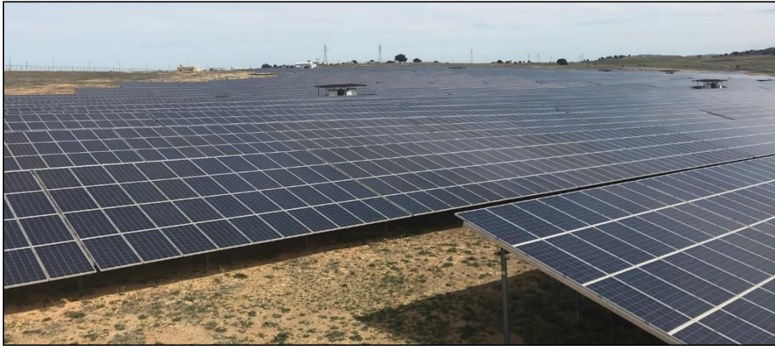
Figure III.2a : Les champs photovoltaïques de la centrale de Dhaya.
