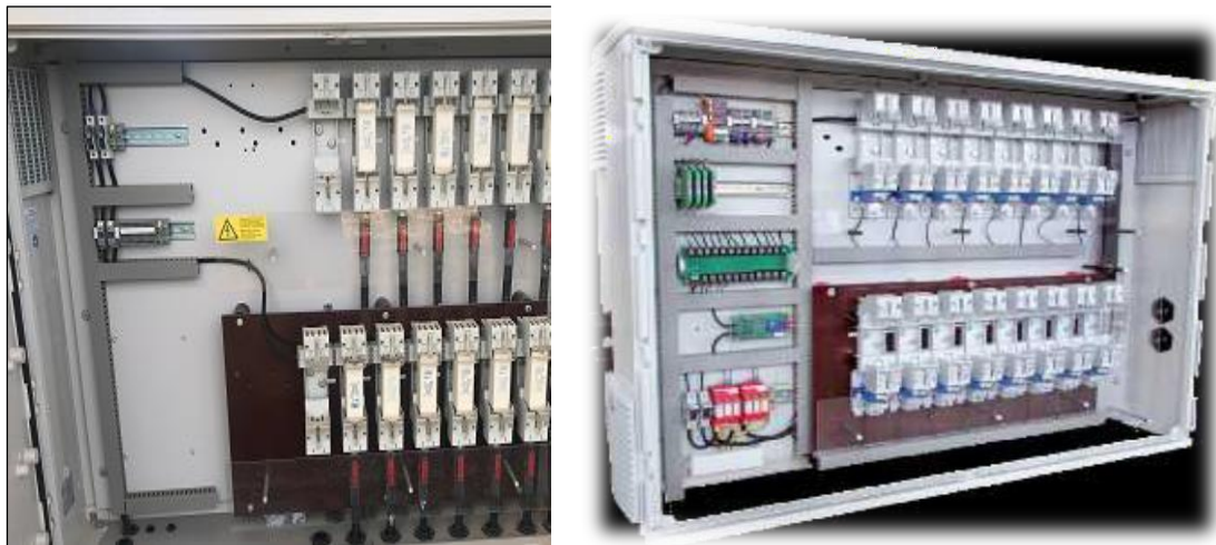
Figure II. 3: les centraux box utilisés dans la centrale PV Dhaya.
