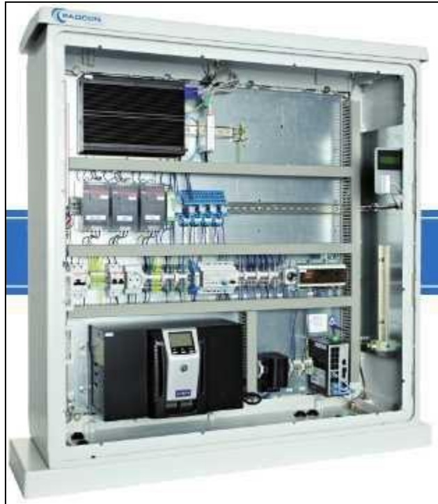
Figure II. 8: Le SMU utilisée dans la centrale PV Dhaya.
