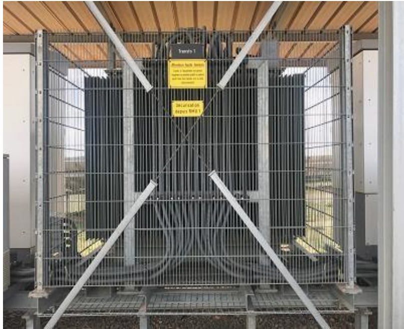
Figure II. 5: Le transformateur de puissance utilisé dans la centrale PV Dhaya.
