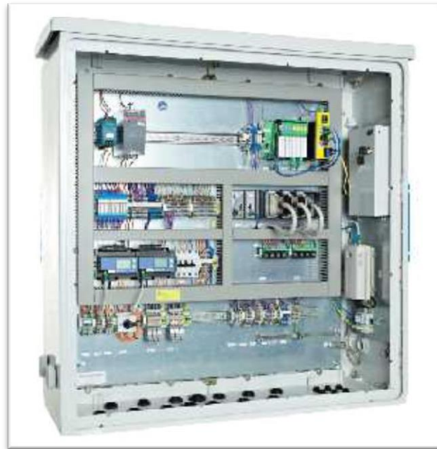
Figure II. 7: Le sonser box utilisée dans la centrale PV Dhaya.
