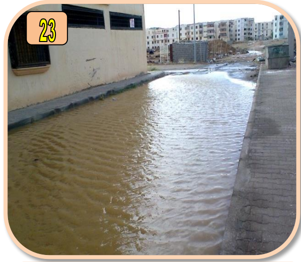
صورة تبين تجمع مياه الأمطار بسبب عدم وجود بالوعات لتصريف مياه الامطار
