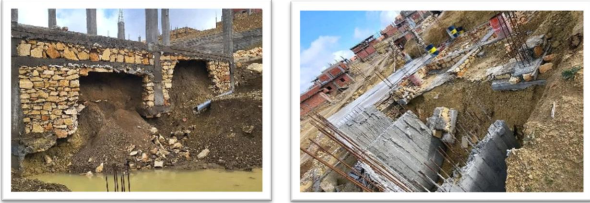
الصورة رقم 1: بنايات قرب الواد وبدون رخصة بناء
