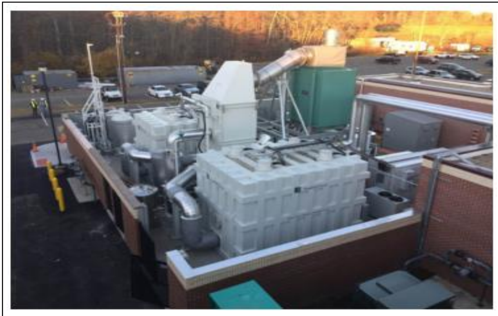
Figure V.5. Application pour un système pile à combustible
