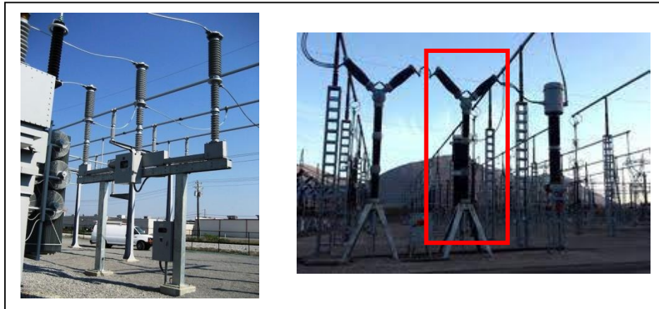
Figure I.12. Disjoncteur à haute tension
