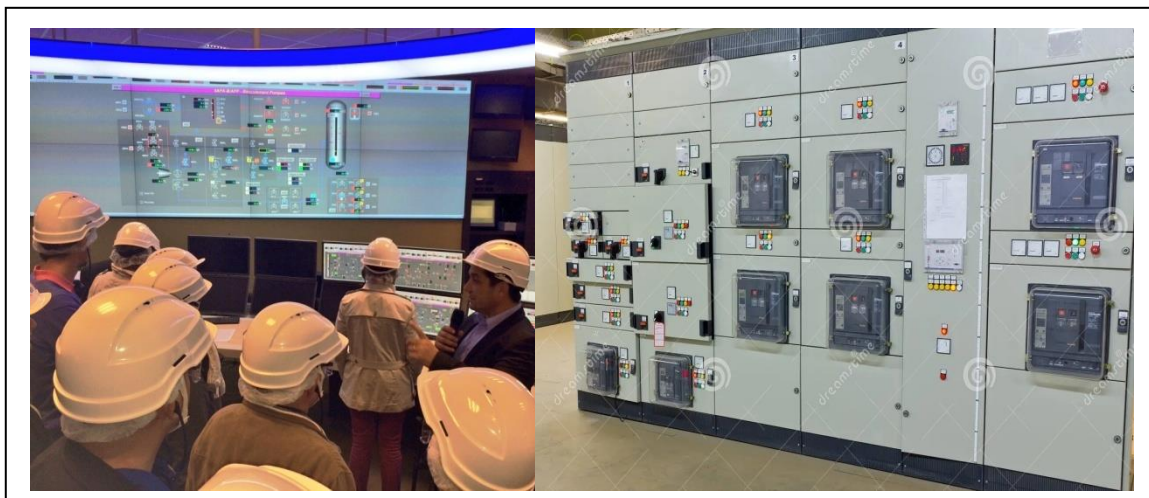
Figure I.10. Les salles contrôle-commande
