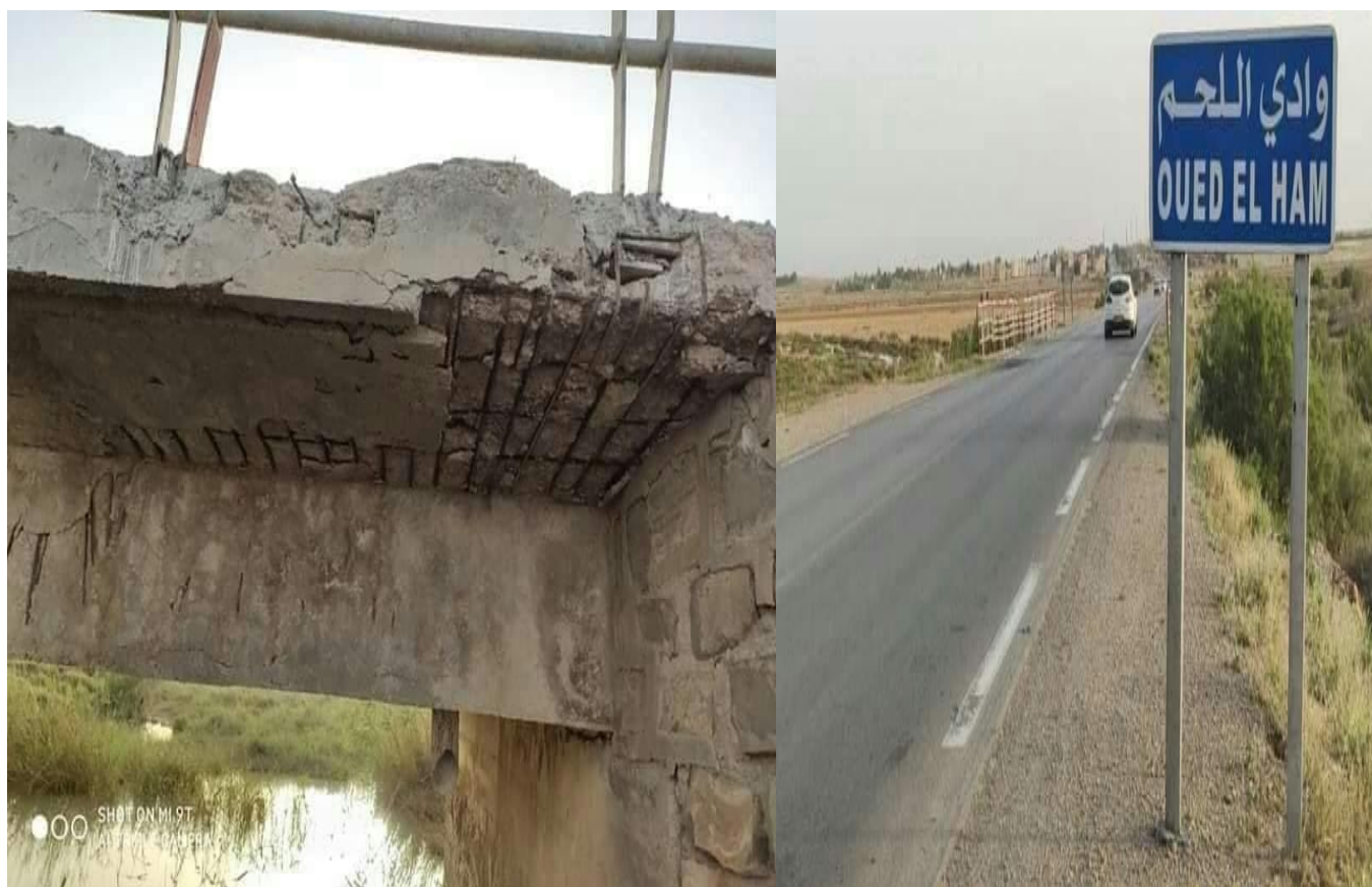
Figure 0-1 : Cas de pathologies de corrosion au niveau de oued el Ham commune de Benyou
