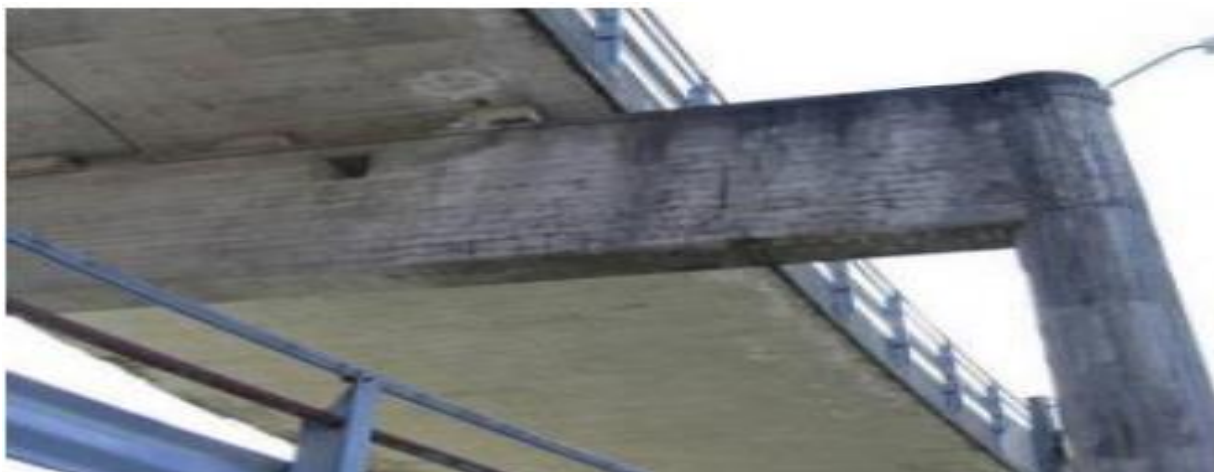
Figure 0-3 : Exemple d'un faïençage dans un pont affecté par RAG, AAR (2013)
