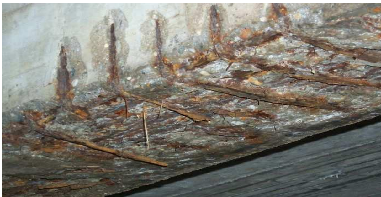
Figure III-6 : Exemples de corrosion des structures en béton armé.
