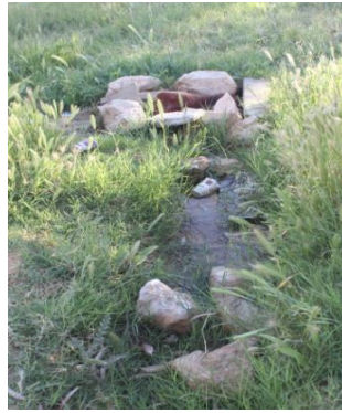
الصورة (33): تسرب مياه
