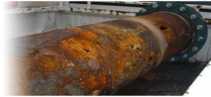
Figure II .04: Pertes de métal dû à la corrosion externe
