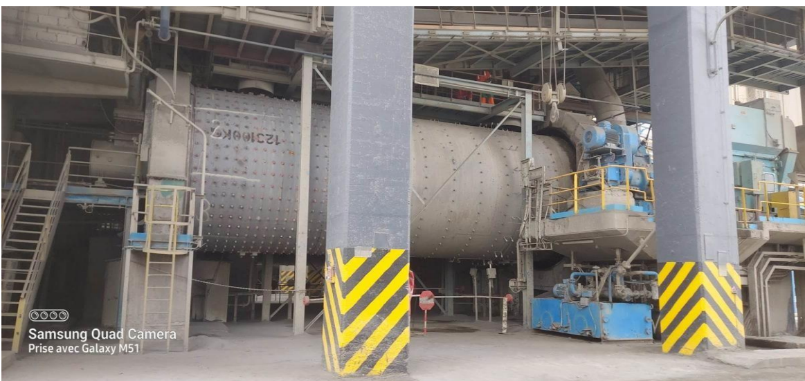
Figure N°12 : Broyeur ciment LCM (avec une capacité de 160 t/h). (GHALIA.S. LAIFA.A, 2023)
