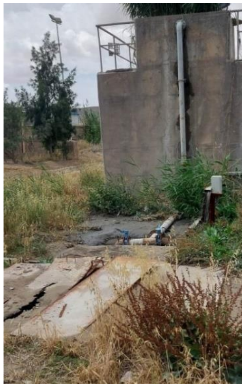
Figure N°24 : Bassin de relevage des eaux usées brutes juin 2023
