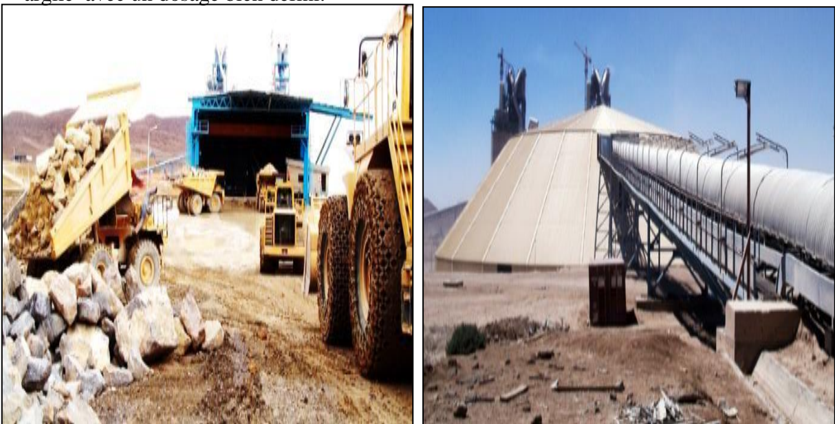
Figure N° 9: Le concasseur à marteau et le transport vers le hall de pré-homogénéisation .PHOTO LCM
