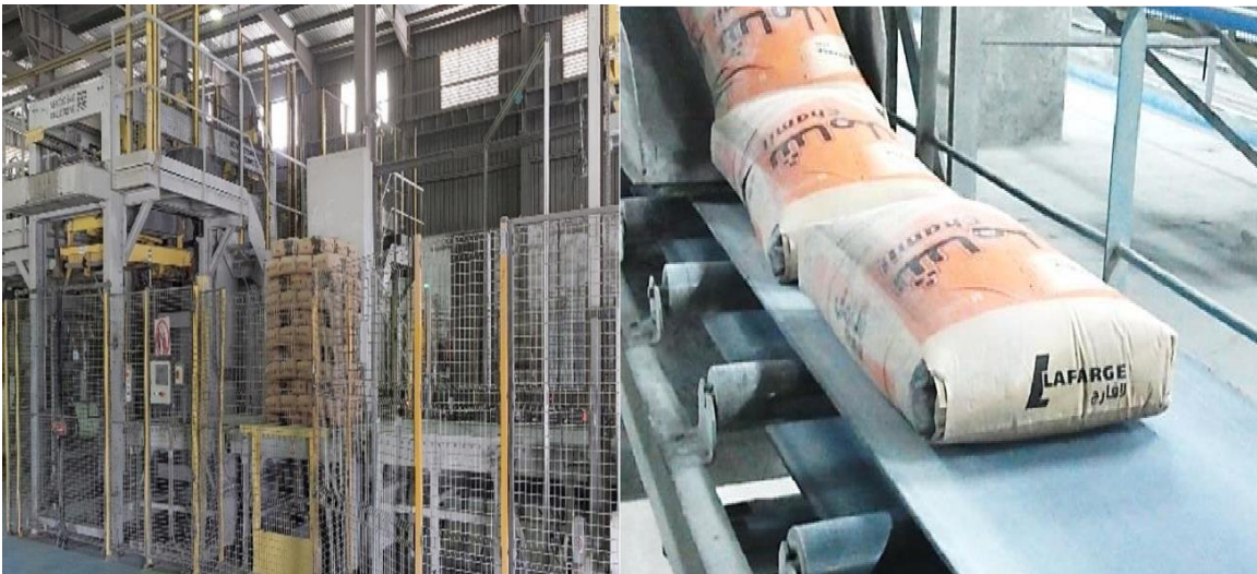
Figure N°13 : la zone d'expédition du ciment Nouvelle Palettisation (GHALIA.S. LAIFA.A, 2023)
