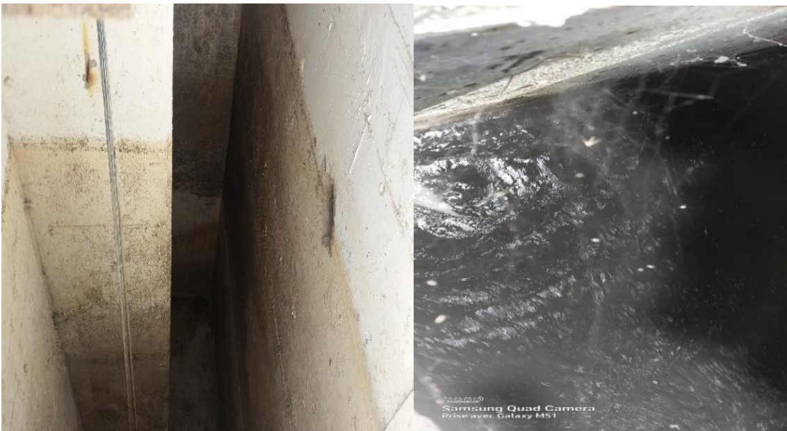
Figure N°27 : Bassin désinfection (GHALIA.S. LAIFA.A, 2023)
