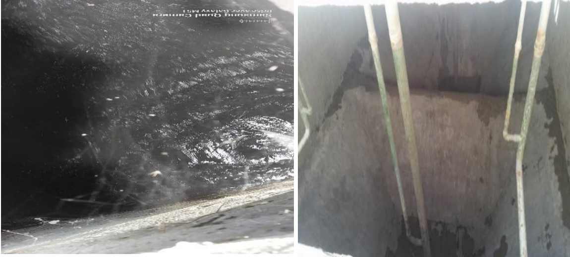
Figure N°26 :Bassin de décantation (GHALIA.S. LAIFA.A, 2023)
