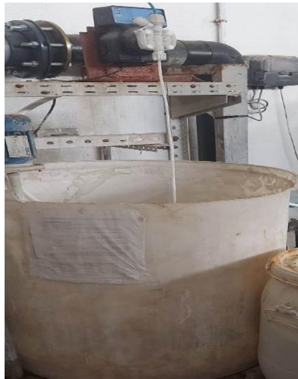
Figure N°28 : réservoir de préparation de chlore(GHALIA.S. LAIFA.A, 2023)
