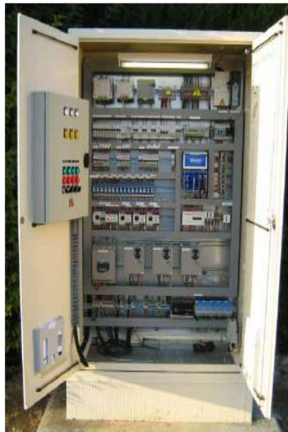
Figure 2 : Vue à l'intérieur d'une armoire électrique [2]
