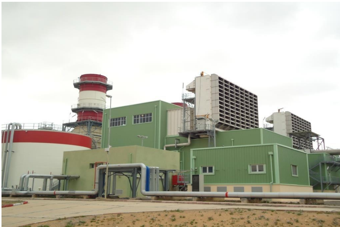
Figure I.1. La Centrale de M'sila III.
