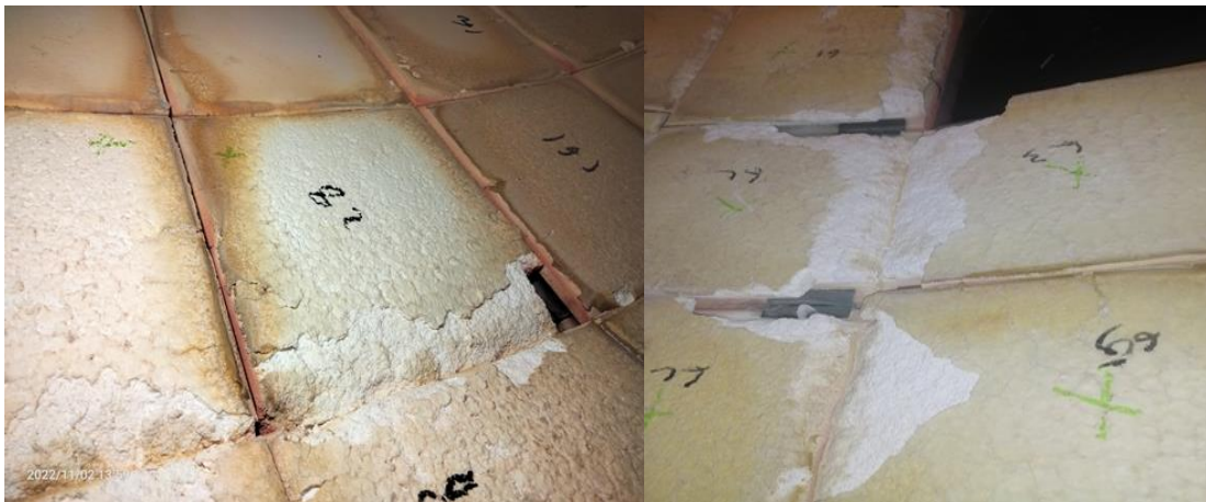
Figure I.16: Dégradation de la chambre de combustion suite au défaut de combustion (TAG V94.3A4 de la centrale de M'sila)
