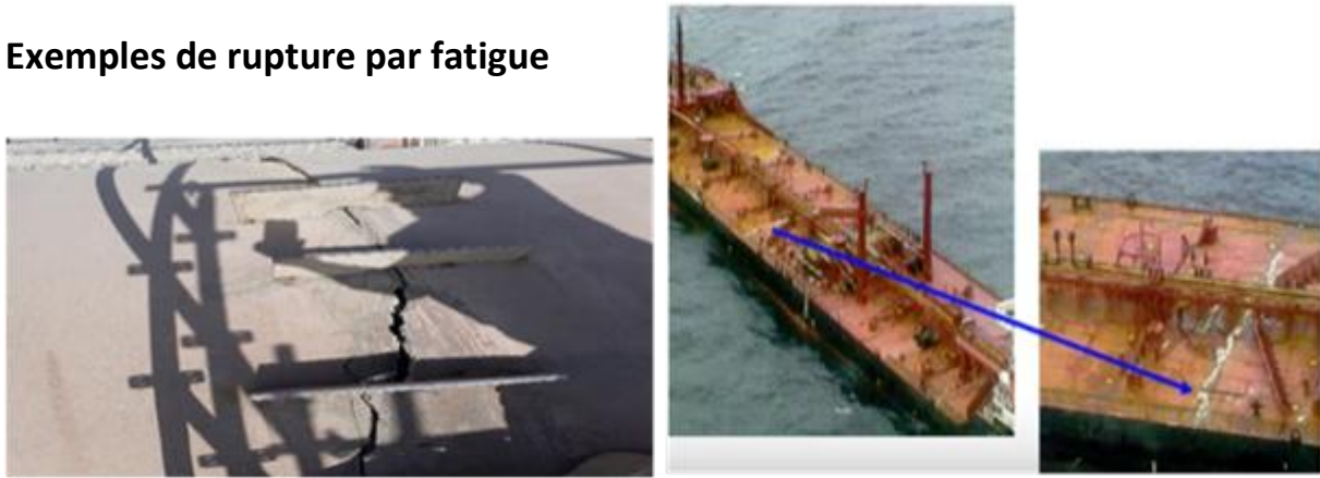
FIGURE III. 3: FISSURE DU FOUR ET LE BATEAU
