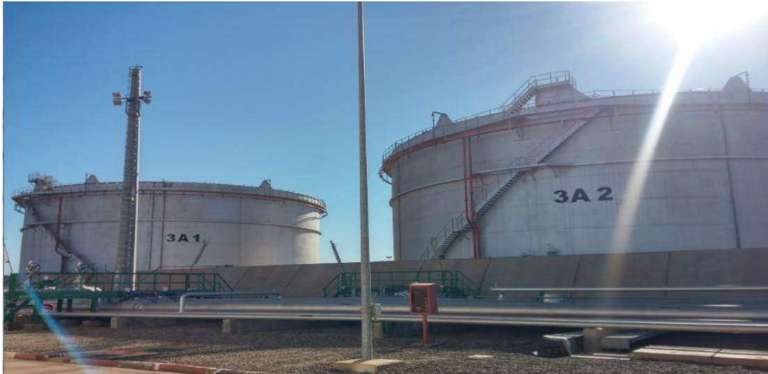
Figure IV.6: Réservoirs de Stockage 3A1- 3A2
