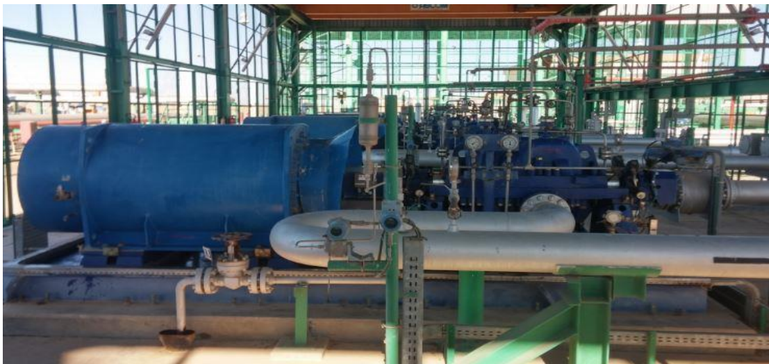
Figure IV.2: Les électro- pompes principale GEP( A,B,C,D,E)
