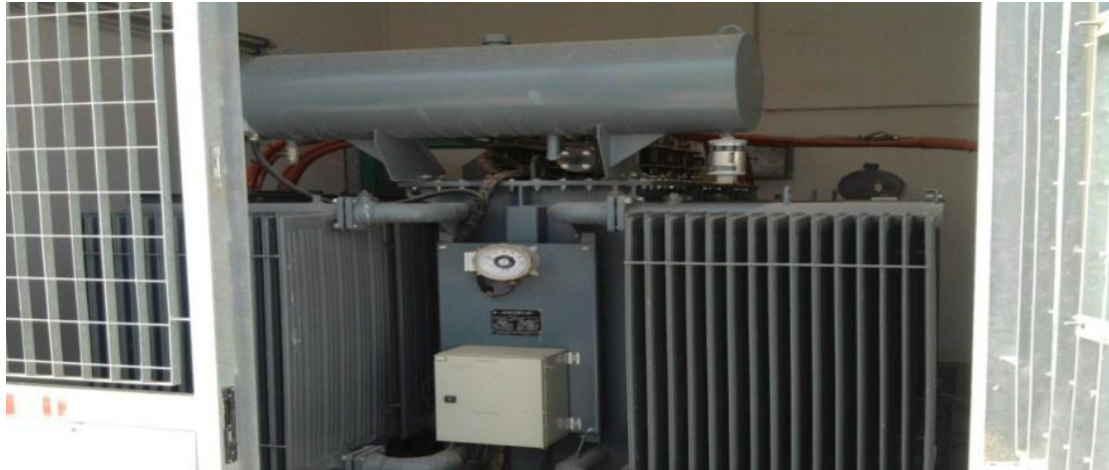
Figure IV.12: Le transformateur MT (5,5KV/2X1,3KV )
