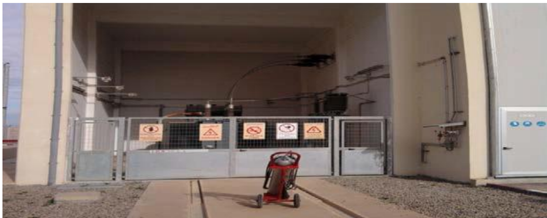
Figure IV.11: Les transformateurs HT –MT 60 KV/5,5 KV
