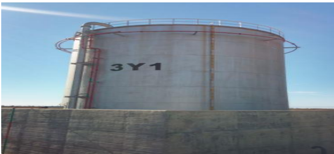
Figure IV.7: Bac de Décantation 3Y1
