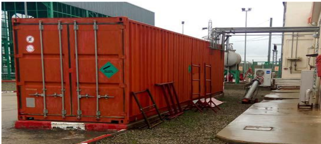
Figure IV.19: système d'extinction au CO 2
