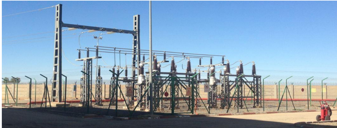
Figure IV.10: La ligne électrique haute tension de 60 kV
