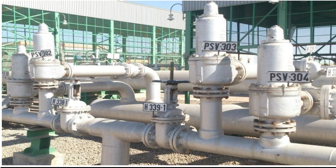
Figure IV.5: Soupapes de décharges PSV 303 et 304
