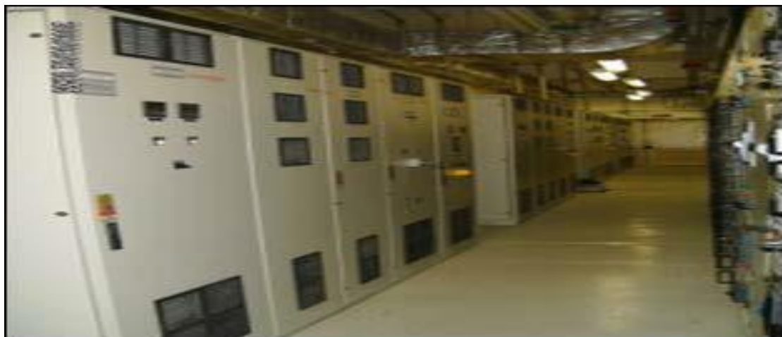
Figure IV.13: Les blocs de variateurs
