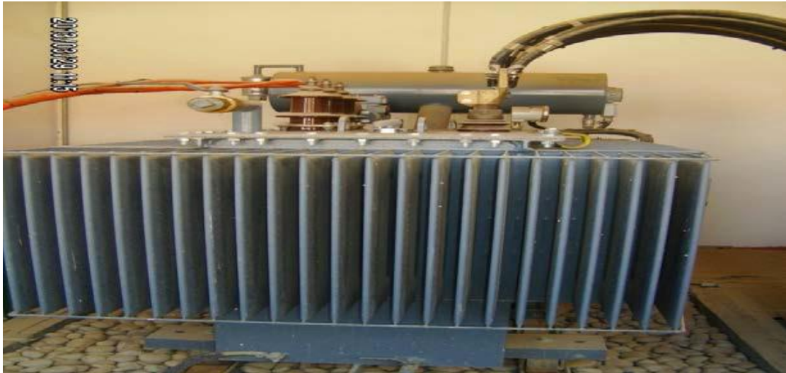
Figure IV.14: Les transformateurs électrique MT/BT 5,5 KV/230-400 V
