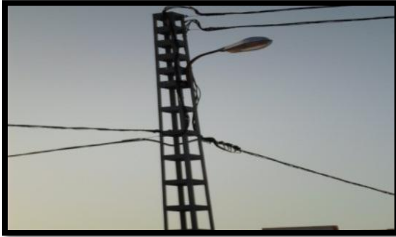
صورة (61): عمود كهربائي
