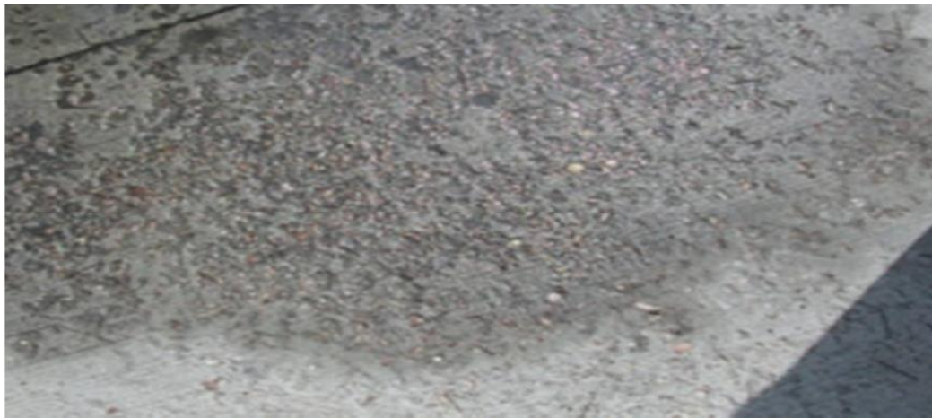
Figure 1.18: Dégradation due aux sels de déverglçage. (IHAB, 2015/2016)
