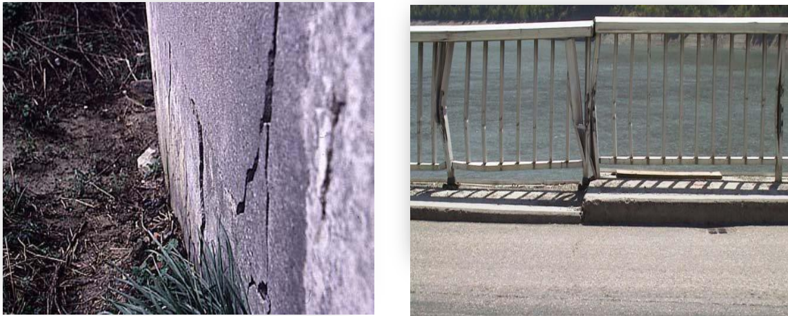
a) Fissuration sévère d'un massif de fondation. b) Exhaussement des bordures de crête sur l barrage du Chambone
