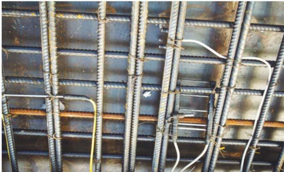
Figure 1.7 : Capteur de corrosion intégré lors de l'extension de la piste d'atterrissage de L'aéroport de Funchal (MAI-NHU, Décembre 2015)
