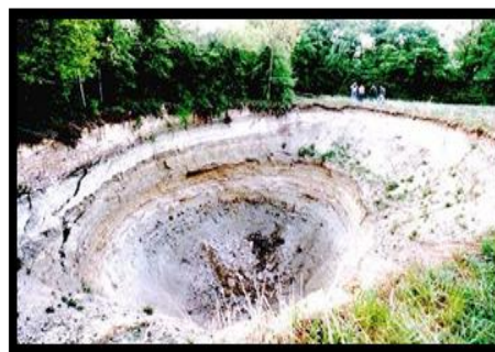
Figure II.11 : Fontis ayant atteint la surface [27].
