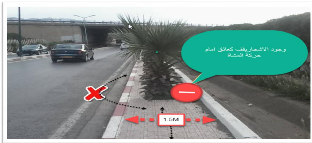
الصورة رقم (16): عرض الرصيف غير كافي ووجود الأشجار كعائق لحركة المشاة .
