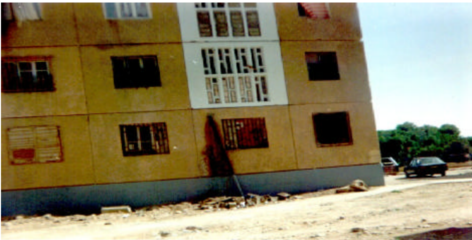
photo IV 2 fuites des eaux usées ( 500 logements)
