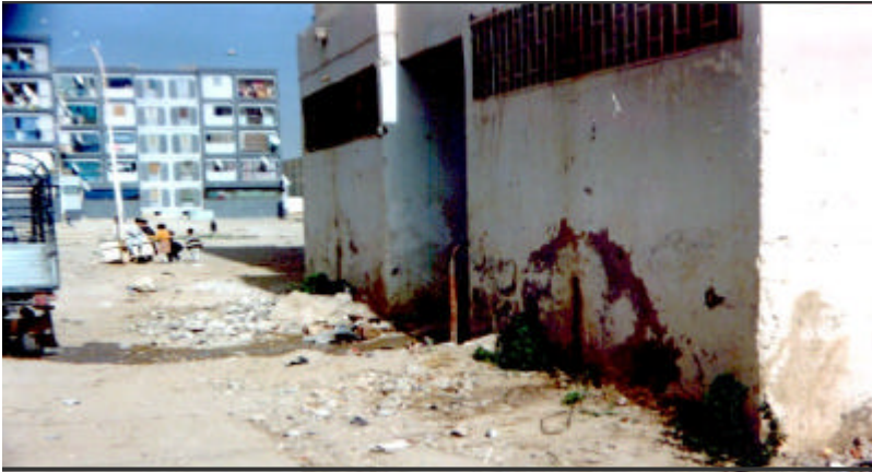
photo IV 1 fuites des eaux usées (1000 logements )
