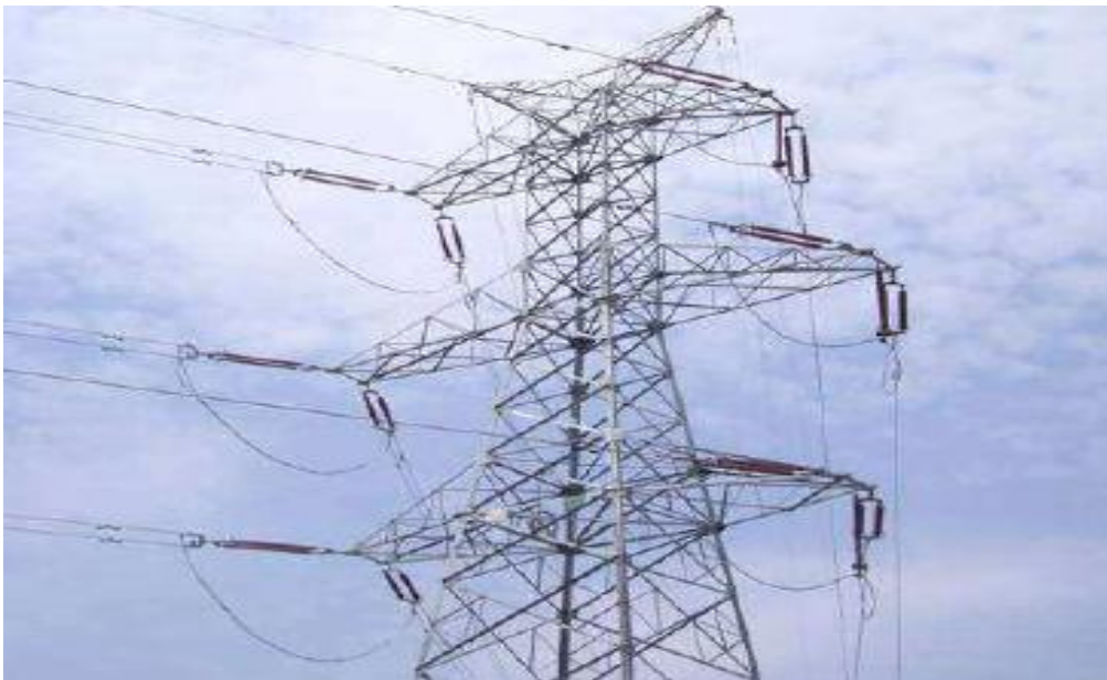
Figure II. 6. Isolateurs composites sur une ligne électrique 220 kV
