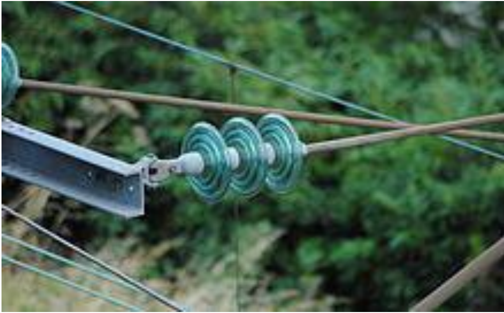
Figure II. 1. Photo représente un isolateur en ligne
