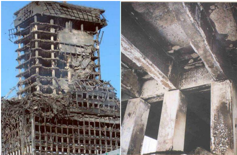
Figure II.15. À gauche, photo du bâtiment Windsor à Madrid après l'incendie. À droite, dessous du tablier du pont à Bruxelles après l'incendie. [22]
