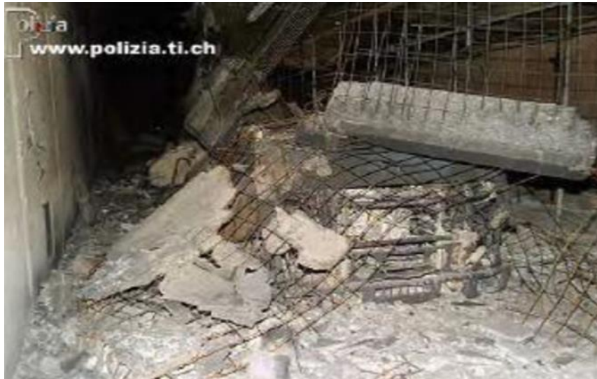
Figure. II.3 : Section effondrée du faux plafond dans le tunnel du Gothard après L'incendie du 21 octobre, 2001.
