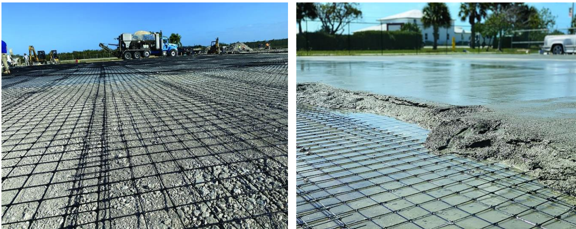
Figure II-09 : Les treillis PRF peuvent être utilisés comme renforcement secondaire dans les dalles sur sol [18].
