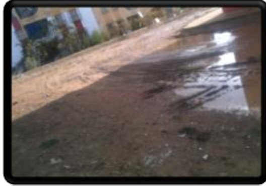
الصورة رقم(22): طريق في حالة متدهورة.
