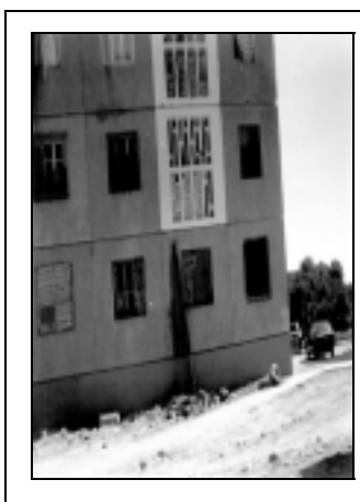
Photo III. 8. Fuites des eaux usées(500 logement)
