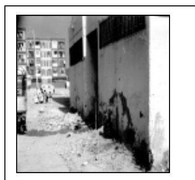
Photo III. 6. .fuites des eaux usées(1000 logement)
