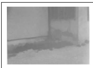
Photo III. 7. Fuites des eaux usées(206 logements)
