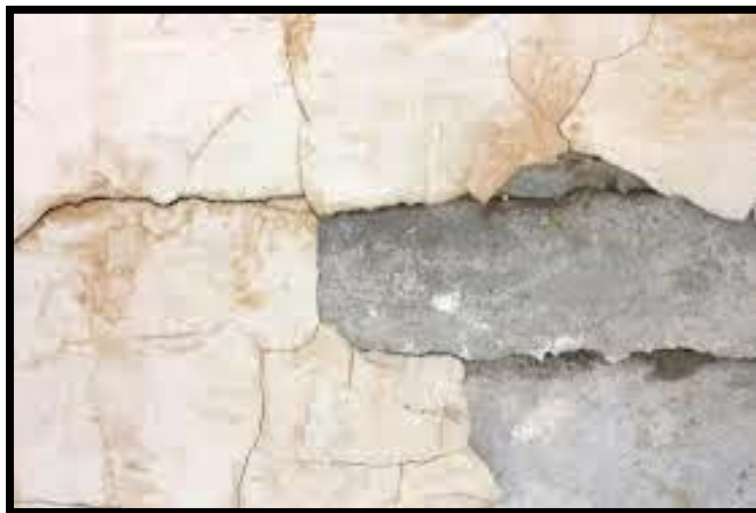
Figure I.9. Eclatement du béton à cause d'une réaction alcali-granulat.
