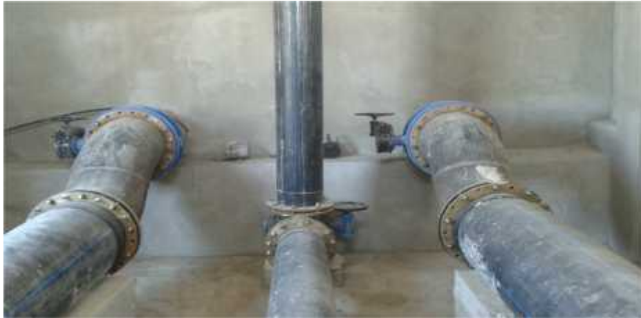
Figure. V.8: Chambre des vannes
