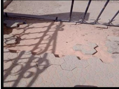
الصورة (29): أرضية مهترئة
