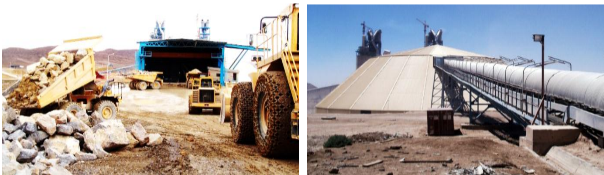
Figure 7 Le concasseur à marteau et le transport vers le hall de pré-homogénéisation.
