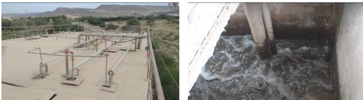
Figure 16 photos du système d'aération.
