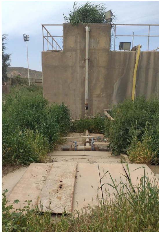
Figure 15 photo du bassin des eaux usées brutes.
