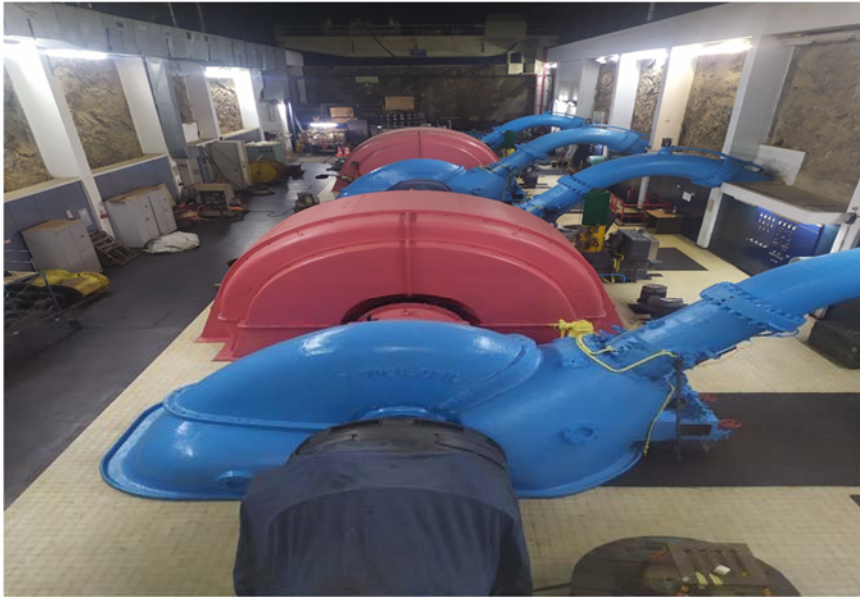
Figure 4.14: groupe de centrale [27]
