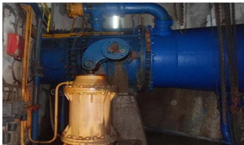
Figure 4.21: vanne de garde [28]
