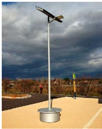
Photo n° 27: : Les mâts solaires
