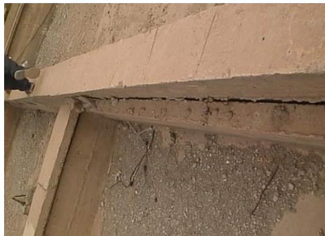
Figure 1. Désordres provoqué par la variation volumique du sol de fondation du site fissuration des murs et ouverture du joint de dilatation
