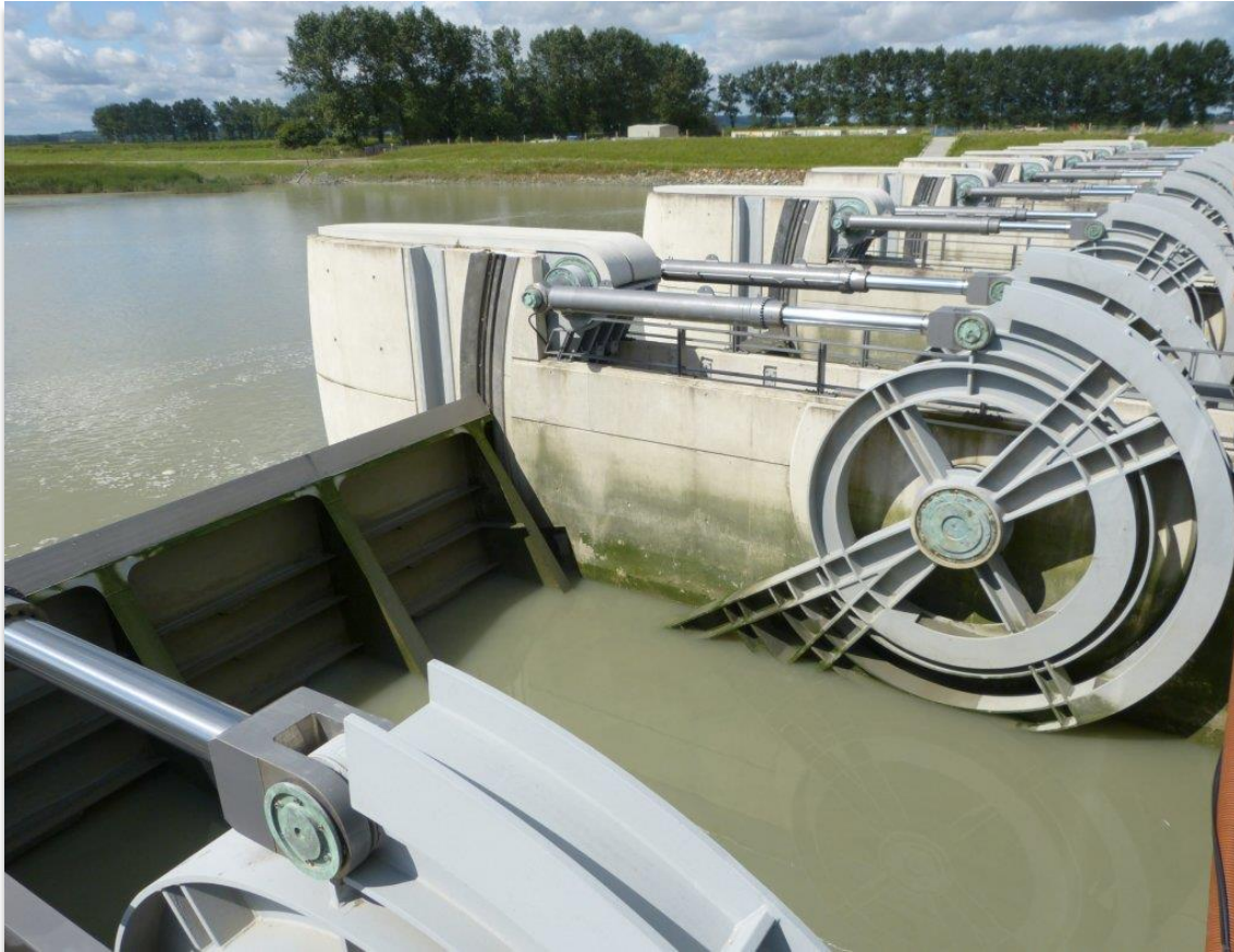
Figure 1.14 : Barrage de mobile à clapets, la caserne- France
