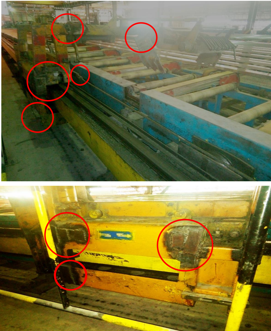
Figure IV.35 - Déformation de la structure de la Tracteur
