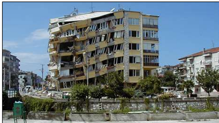
Figure I.21 : Destruction des bâtiments par torsion du béton armé, Séisme de Gölcük, 17 août 1999 (Turquie) [6].
