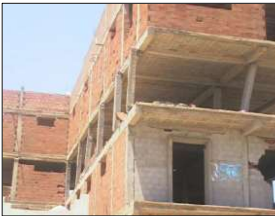
Figure I.7 : Cisaillement des poteaux d'une construction à Bordj el bahri. Séisme de 2003, Boumerdes, Algérie [8].
