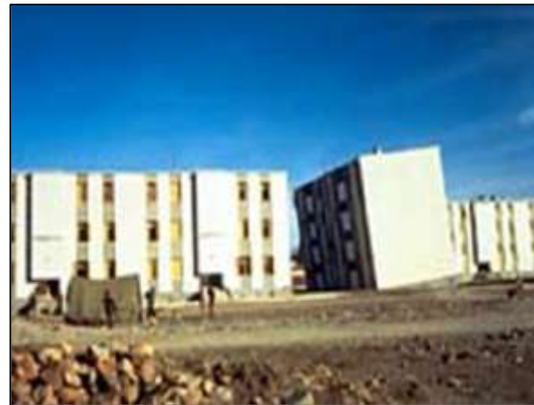
Figure I.3 : Bâtiment d'habitation de 3 étages, (EL Asnam, Algérie), est endommagé par le séisme de 1980 d'EL Asnam [8].
