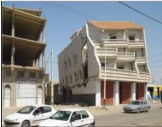
Figure I.13 : Destruction par cisaillement du poteau court, poteau endommagée par le séisme de Boumerdes, Algérie [14].
