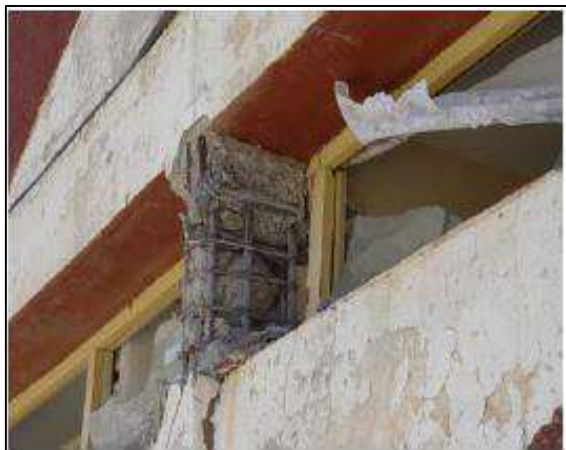
Figure I.15 : Destruction des poteaux à cause du fonctionnement en "poteaux courts", seisme de 2003 Boumerdes [14].
