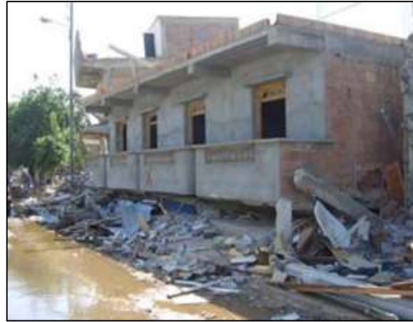
Figure I.5 : Effondrement 'étage souple' du RDC– Séisme de 2003, Boumerdes, Algérie [7].
