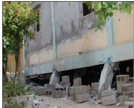
Figure I.16 : Détail de destruction des poteaux à cause du fonctionnement en "poteaux courts" [1].
