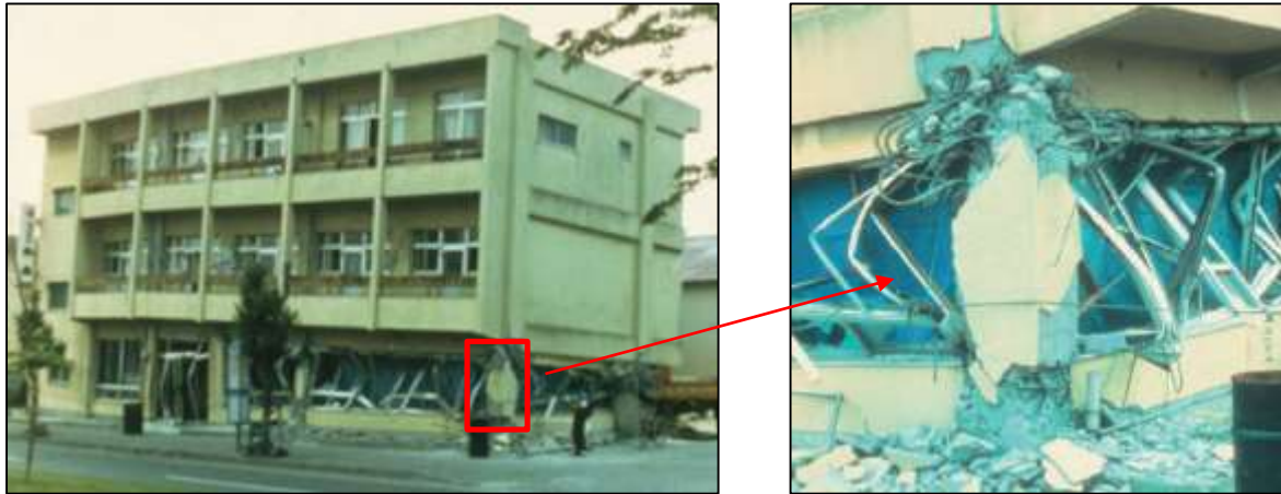
Figure I.22 : Dommages aux poteaux d'angle dus à la torsion induite par l'excentrement des murs de contreventement du rez-de-chaussée (la disposition asymétrique des voiles), séisme de Tokachi-Oki, Japon, 16.5.1968 [8].
