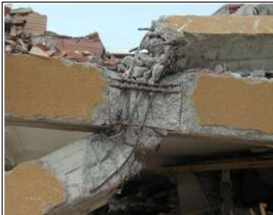
Figure I.17 : Rupture de la zone nodale [5].
