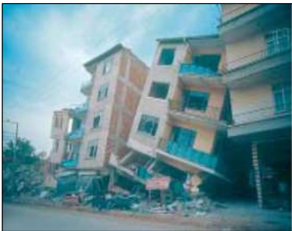
Figure I.2 : Destruction du RDC [12].
