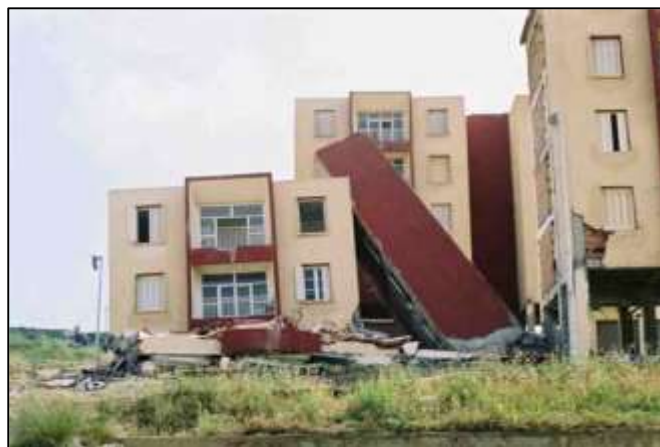
Figure I.24 : Immeuble (R+4) ,140 logements à Dellys (Séisme de Boumerdes 2003), Algérie [1].
