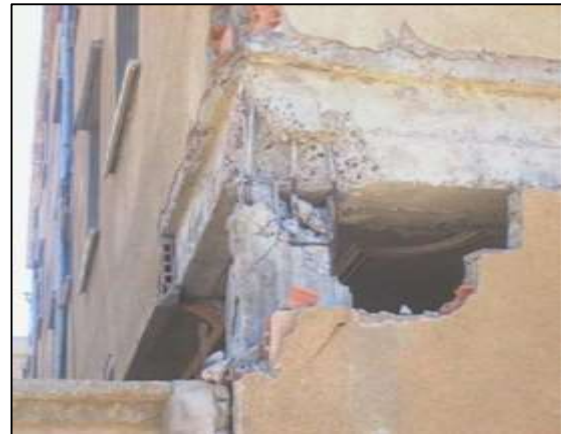
Figure I.18 : Formation de rotule plastique, Bordj el bahri. Séisme de 2003, Boumerdes, Algérie [8].
