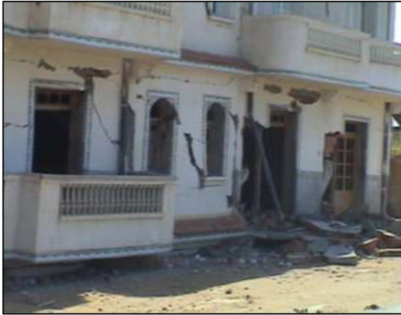
Figure I.4 : Disparition du Rez-de-chaussée (RDC est effondré complètement (étage souple)), Zemmouri ville, Séisme de 2003, Boumerdes, Algérie [8].
