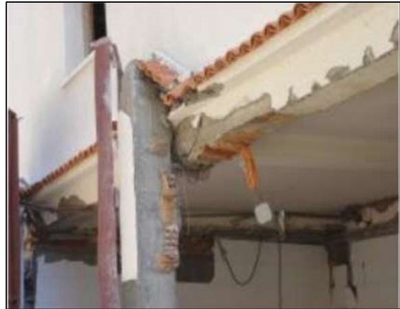
Figure I.14 : Dommages dus à l'effet de poteau court en vide sanitaire [14].
