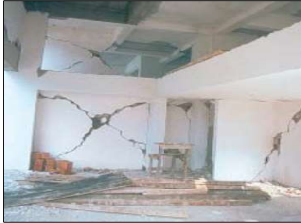
Figure I.11 : Des endommagements à cause de remplissage partiel, (Izmit, Turquie, 1999) [12].
