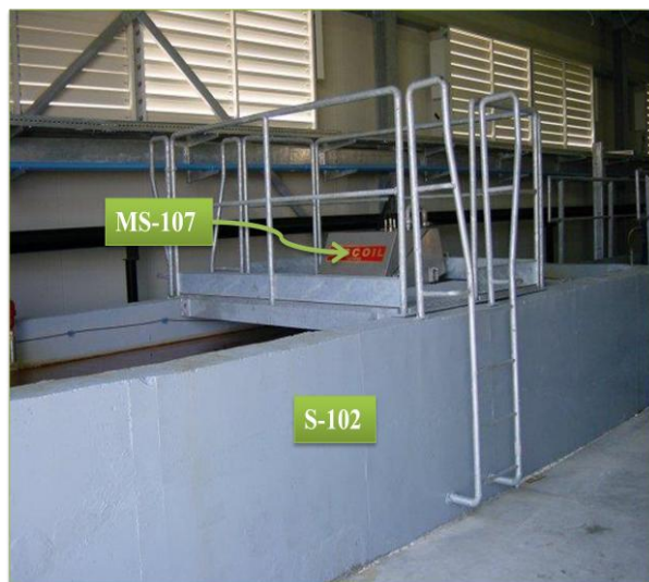
Figure (I-6) : La cuve CPI
