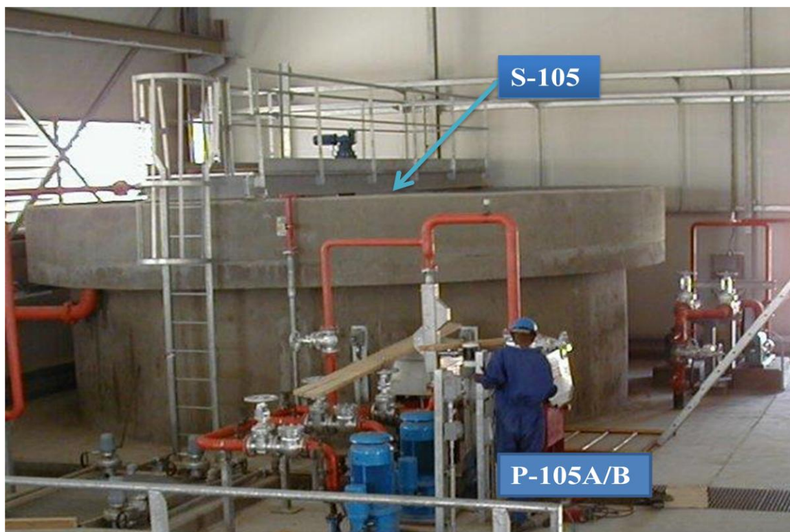
Figure (I-10): Cuve d'épaississement de boues
