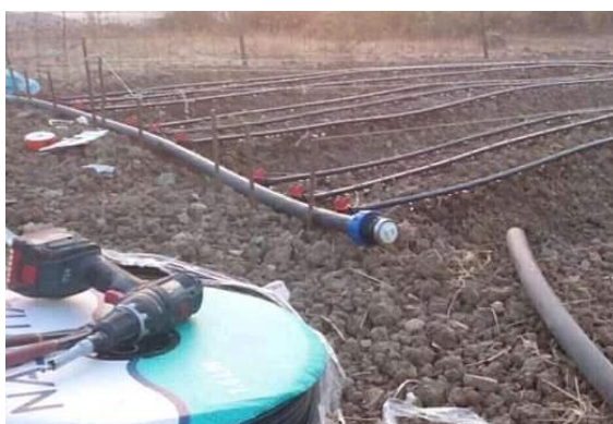
Figure 32 : les rampes et les conduites
