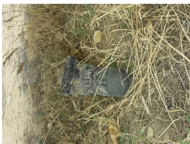
Figure 31 :Vannes de sectionnement
