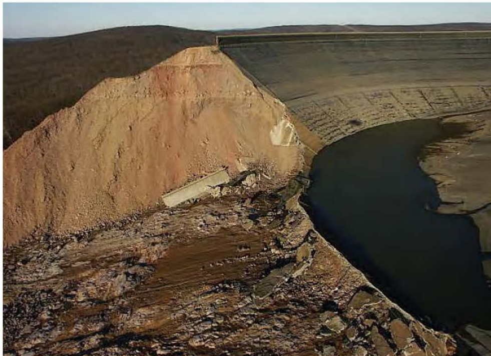
Fig I.21 Vue de la brèche dans le remblai du barrage de Tauma Sauk [14]
