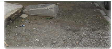
Figure 48.49: La mauvaise état des trottoirs
