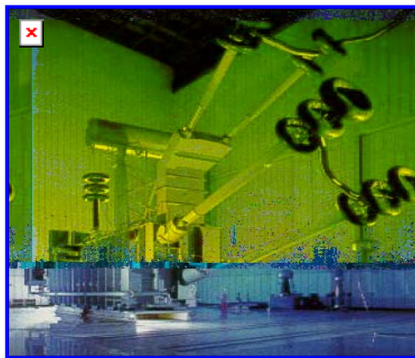
Fig. I.13 : transformateur de conversion.
