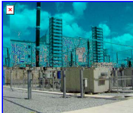
Fig. I.14 : Exemple Filtre CC actif de 200KVA
