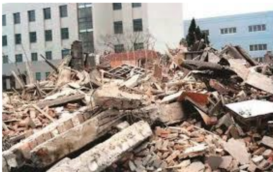
Figure.II.10. Déchets de construction
