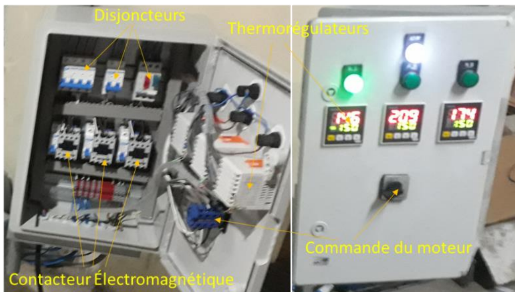
Figure IV.4. Éléments d'armoire électrique
