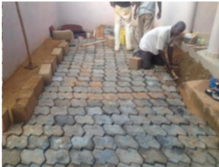
Figure III.6. Exemple de cour de maison à Bamako avec des pavés autobloquants échantillons avec des déchets plastiques fondus [10]
