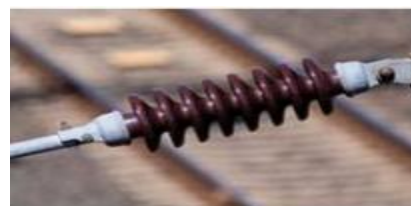
Figure I.2: Isolateur céramique utilisé pour supporter les câbles hauts tension
