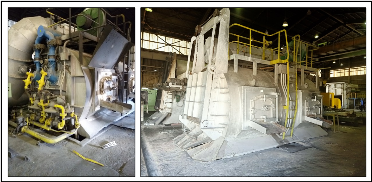
Figure 1.5: Fours de fusions et de maintien 5 Tonnes.
