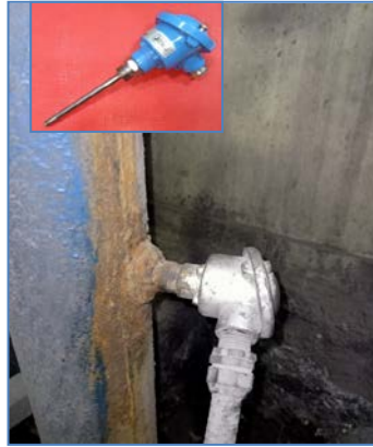
Figure 2.18 : Emplacement de PT100 à la canalisation d'eau de refroidissement.
