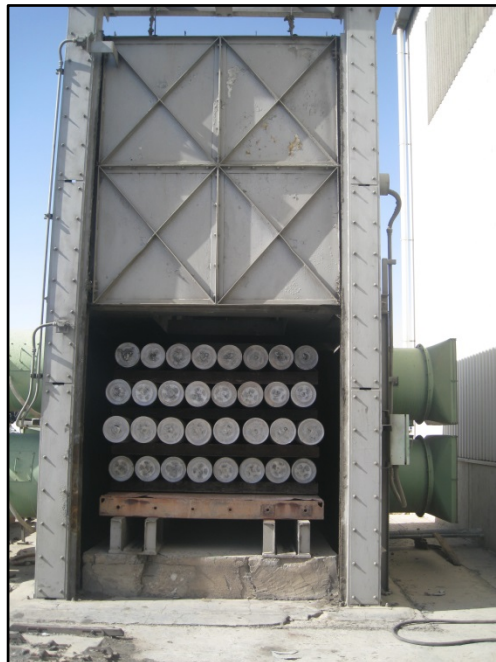
Figure 1.15 : Chambre de refroidissement de billettes.
