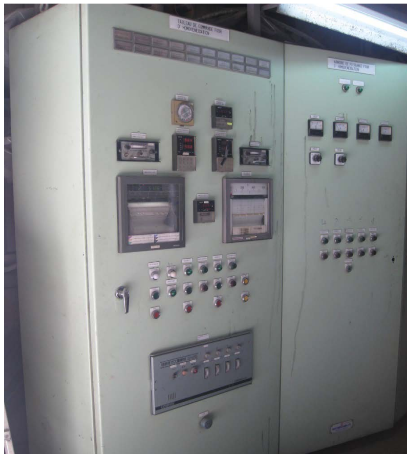
Figure 1.14 : Armoire électrique de commande classique du four H.
