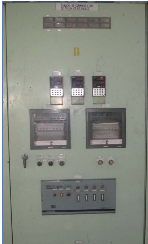
Figure 1.6: Armoire de commande des fours de fusion.
