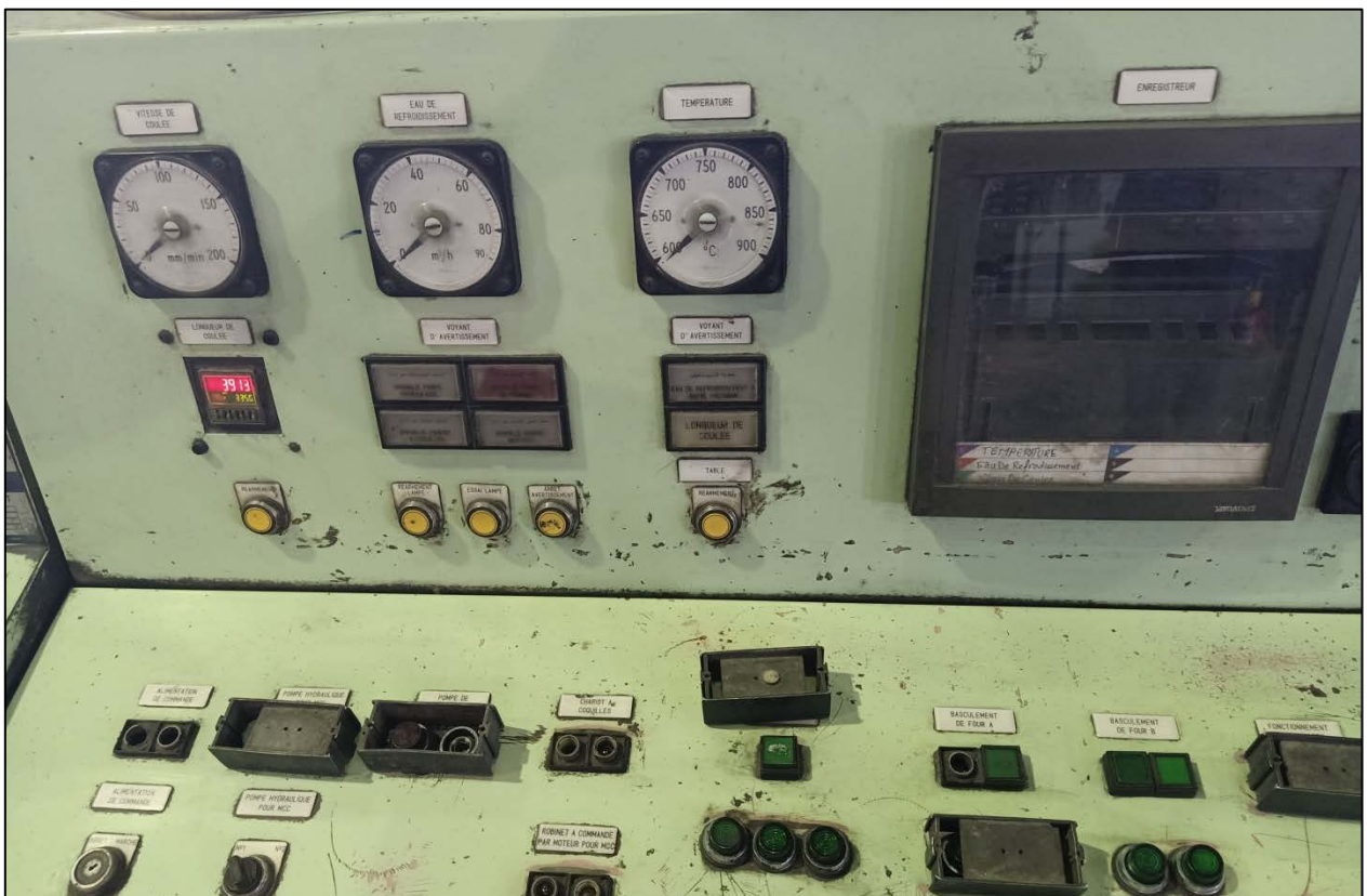
Figure 1.11 : Armoire de commande classique de MCC.
